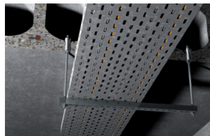
Trasy kablów w betonowych płytach kanałowych
