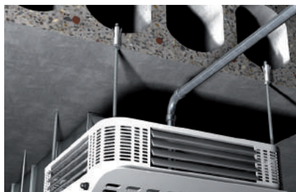
Klimatyzacja w betonowych płytach kanałowych
